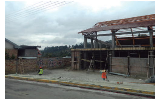
Año 2016 Estado Actual: Sustituida
