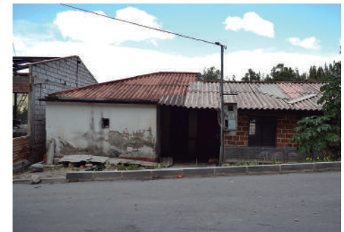
Año 2016 Estado Actual: Sustituida
