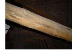
PRESENCIA DE POLILLA EN TIRANTES
