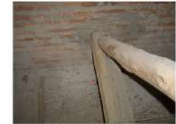
PRESENCIA DE POLILLA EN UNIONES
