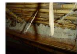
PRESENCIA DE POLILLA EN VIGAS Y CARRIZO
