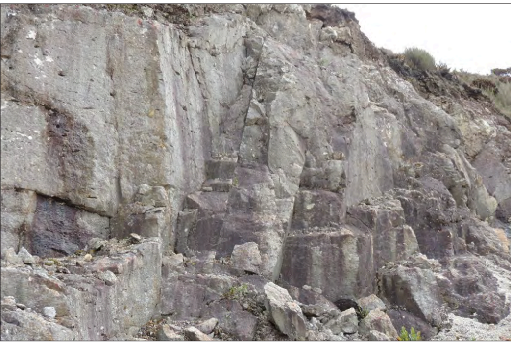
Figura 11 Diaclasas y fracturas en la vía
