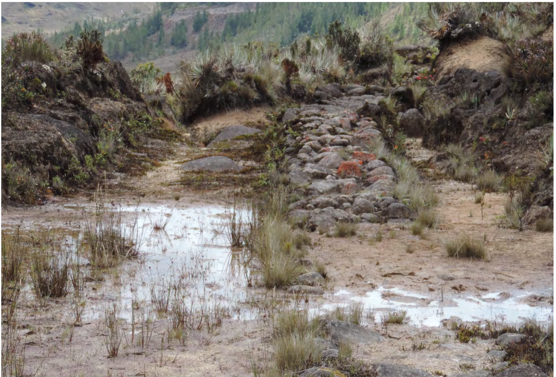
Figura 50 Camino empedrado en proceso de destrucción por inundación.
