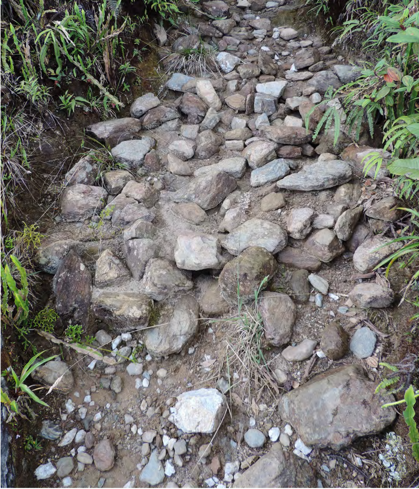
Figura 167 Calzada del camino en proceso de destrucción .
