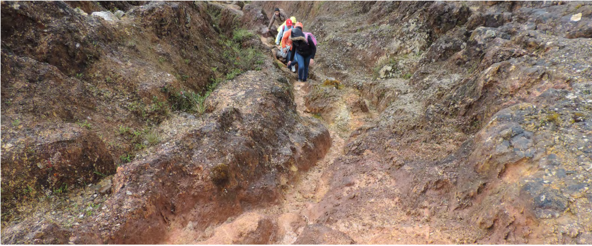
Figura 69 Cimentación del camino destruido por cárcavas y restos de un canal lateral a la izquierda de la fotografía.
