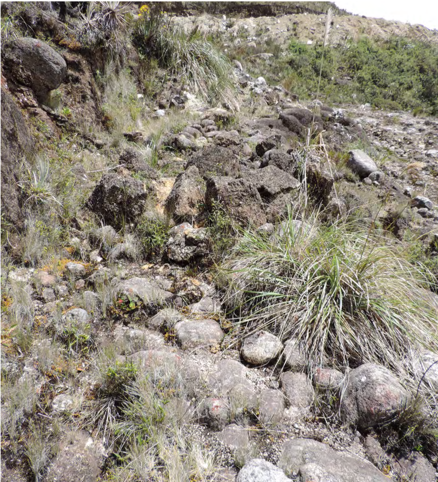
Figura 54 Segmento de camino cubierto de escombros de un derrumbe.
