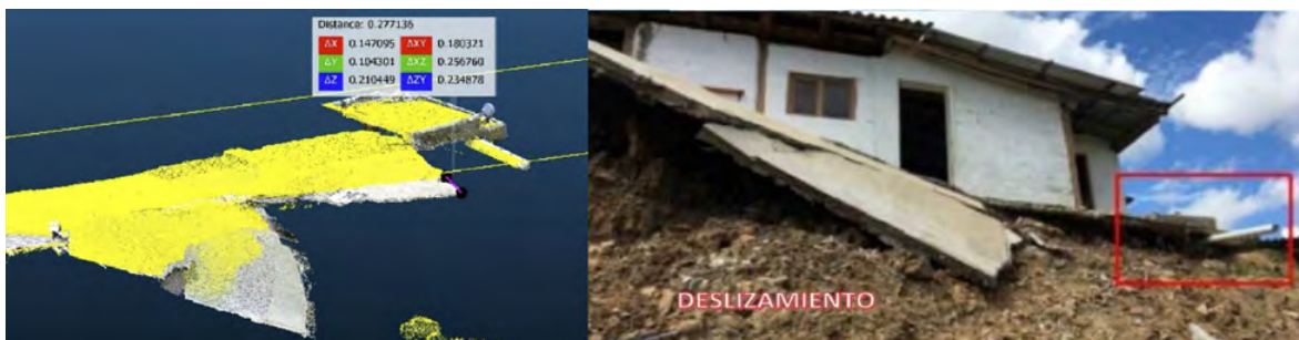
Figura 2: (Izquierda) Losa cercana al deslizamiento, en amarillo: escaneo de mayo y en RGB: escaneo de junio, (derecha) losa en campo.
